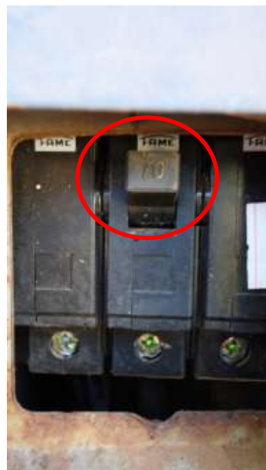
Figura 3 – Detalhe mostrando a corrente do disjuntor
