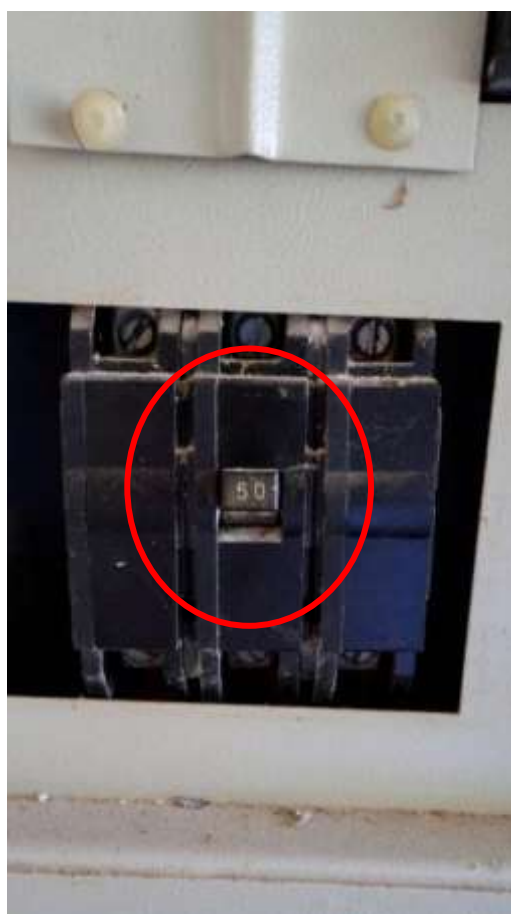
Figura 8 – Detalhe do Disjuntor Geral do quadro de distribuição
