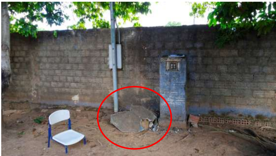
Figura 4 – Detalhe da primeira caixa de passagem depois da entrada de energia
