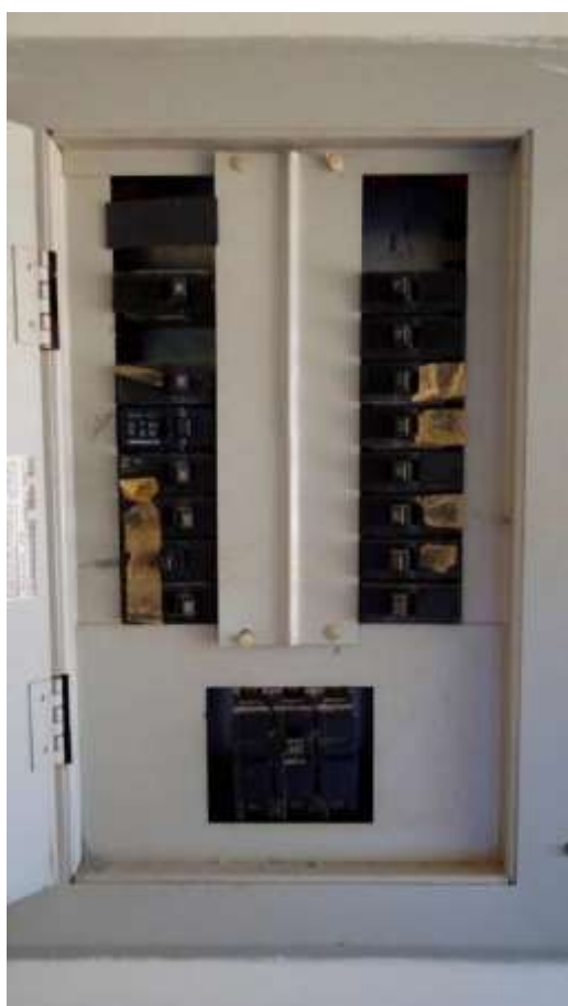
Figura 7 – Quadro de distribuição com a tampa aberta
