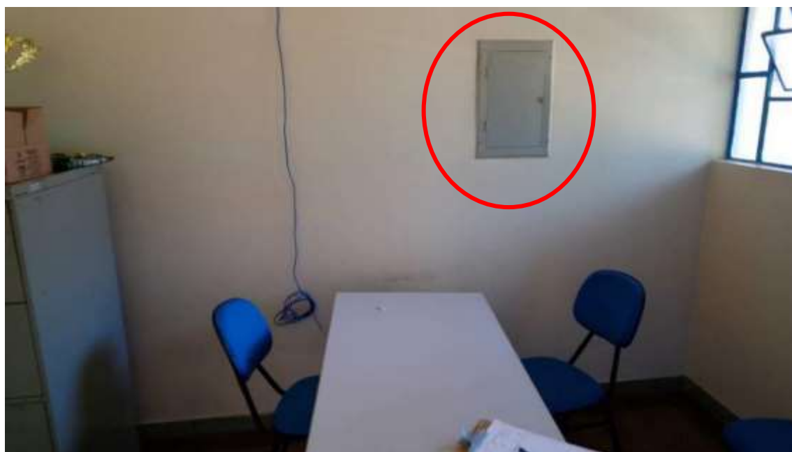
Figura 6 – Vista Geral quadro de distribuição
