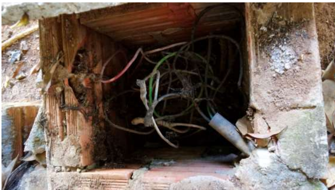
Figura 5 – Foto da primeira caixa de passagem aberta com a fiação
